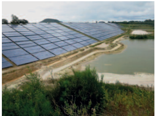
Bild 27: Teil des Solarparks
